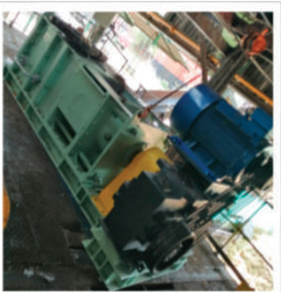
Instalación de la prensa de raquis #2
