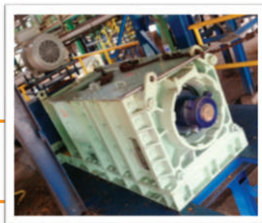
Instalación de la prensa de raquis #1
