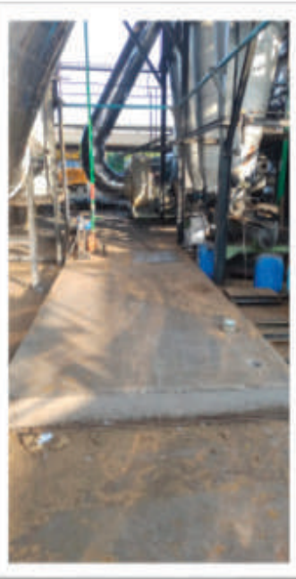
Sistema de recuperación de agua a partir de los condensados de vapor de las calderas
